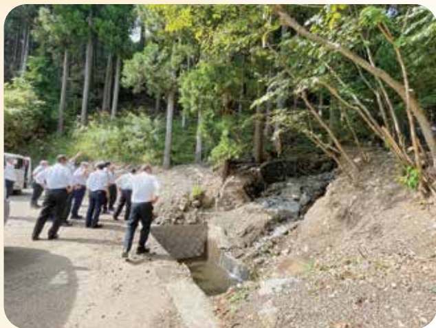
▲ 大雨により土砂が大量に流出した林道 (林道棚沢大成線・林道棚沢今川線)
