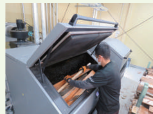
薪ボイラー（再生可能エネルギー）
