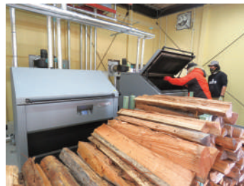
新たに導入した小管の湯薪ボイラー
