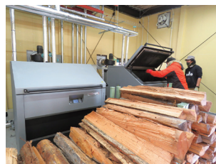
新たに導入した小菅の湯薪ボイラー
