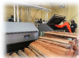
新たに導入した小菅の湯薪ボイラー
