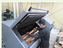
薪ボイラー(再生可能エネルギー)
